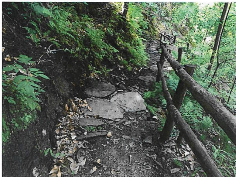
Eliminazione della staccionata per mancanza di stabilità.
